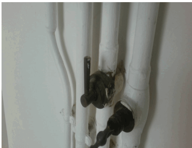
Réseau 1 : Gaz naturel (Gaz H), Distributeur NC, N° compteur 1617b104647173) 7a3) WIN_20230711_11_40_16_Pro
